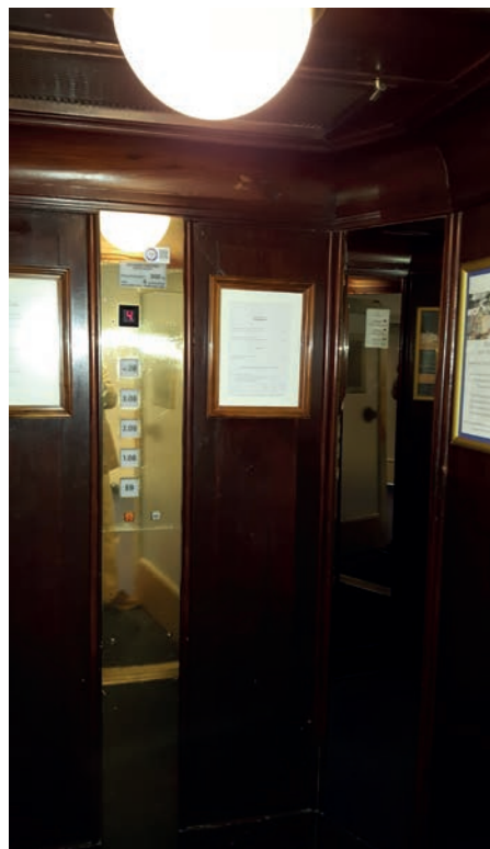
Kabine von innen mit Bedienelement
