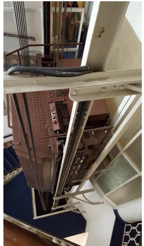
Fahrkorb von außen im Schacht
