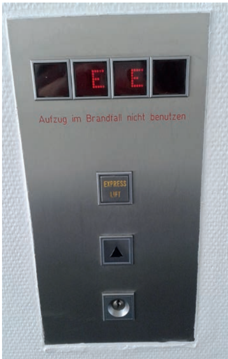
Bild 4: Blick auf das äußere Bedienelement des Express-Lifts zur Hermes-Lounge im Bürohochhaus
